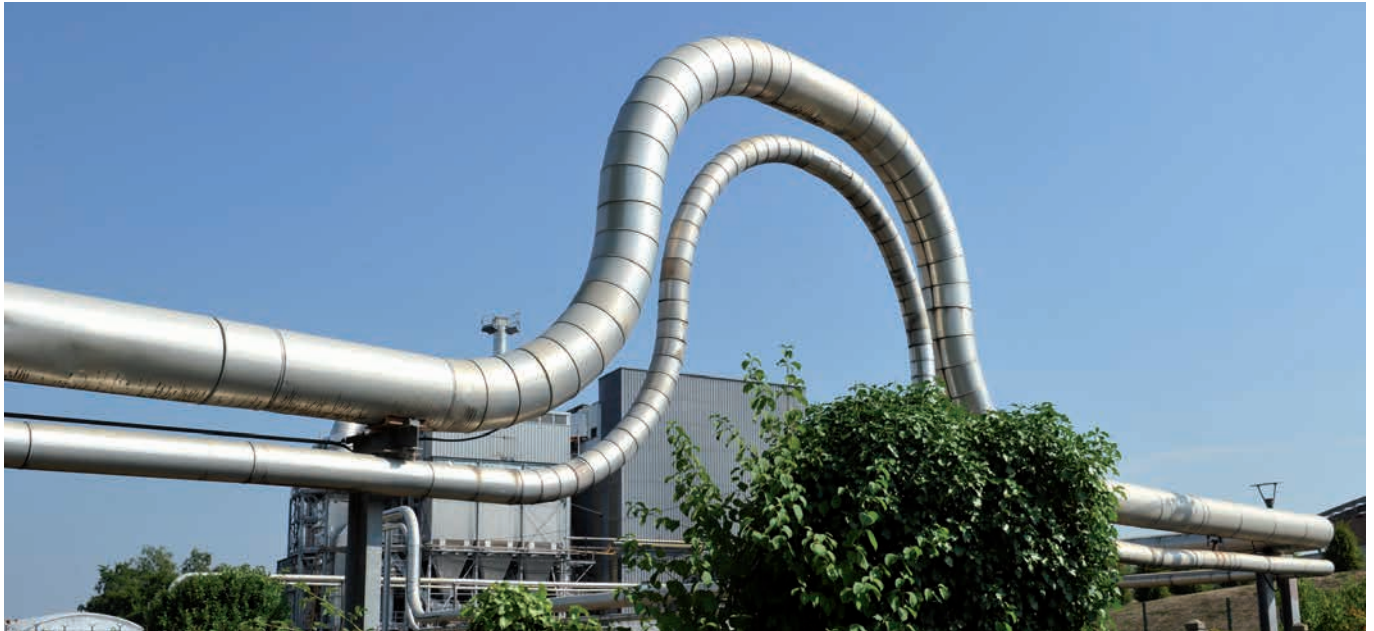
Système mixte. Outre le bois et le gaz, la chaufferie biomasse fonctionnera avec l'énergie perdue de l'usine d'incinération.
